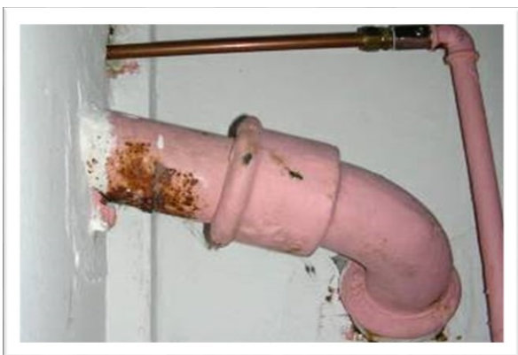
EX 11.11. Gennemtærede støbejernsfaldstammer samlet med blystøbning, hvilket tidligere både var eneste mulighed og lovligt. (Foto: Aktuel Bygge Rådgivning)
