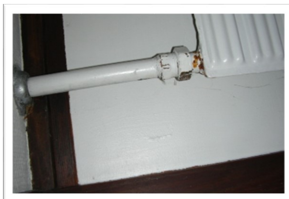
EX 11.10. Utæthed pga. korrosion i varmeanlæg, sandsynligvis som følge af tidligere åbent centralvarmeanlæg, nu ombygget til lukket anlæg. Dryp på parketgulvet! (Efter 1972). (Foto: Aktuel Bygge Rådgivning)
