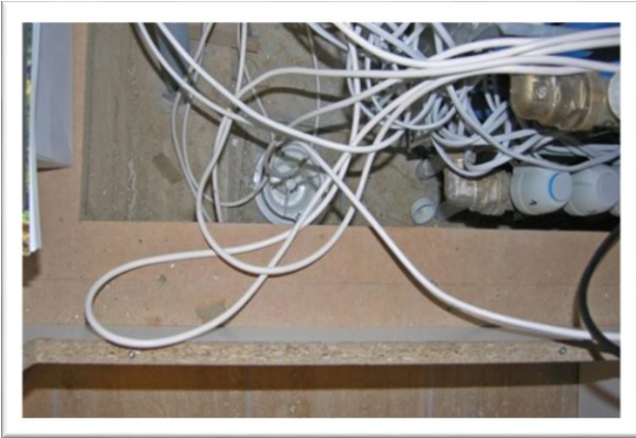
EX 11.3. Gulvfløb placeret svært tilgængeligt i bunden af et skab. (Foto: Erik Brandt)
