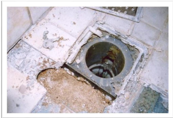
EX 11.1. Nedbrudt gulv pga. gulv afløb, som ikke er korrekt monteret. (Foto: Erik Brandt)
