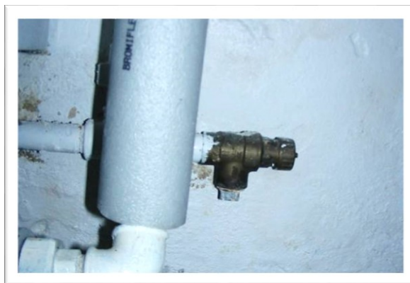
EX 11.6. Afproppet sikkerhedsventil, hvilket forårsager fare! Iht. AT-vejledning og vandnormen må sikkerhedsventiler ikke afproppes, men skal nedføres farefrit over recipient og på en sådan måde, at utilsigtet afspærring ikke umiddelbart kan ske, fx med skråt afskåret rør. (Foto: Aktuel Bygge Rådgivning)
